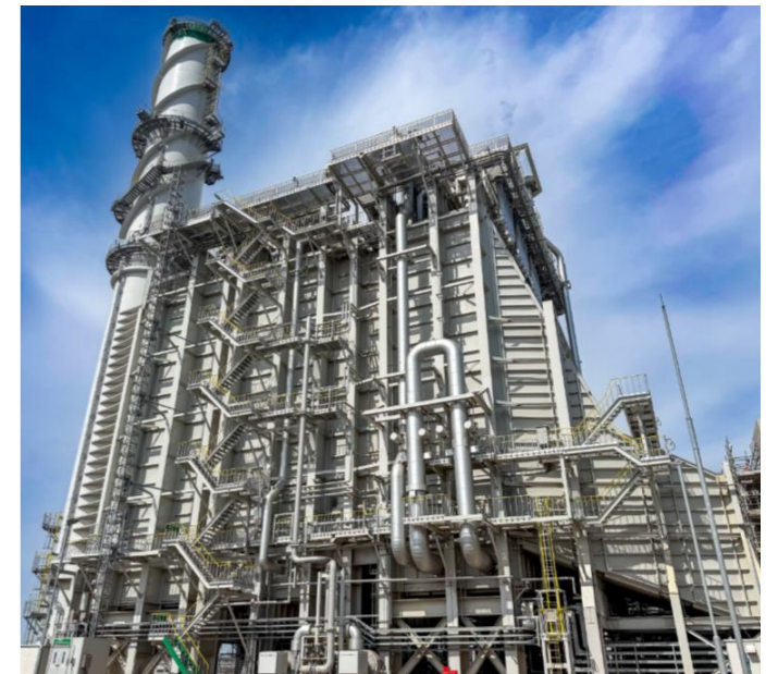
排煙脱硝装置を備えた排熱回収ボイラ(HRSG)
